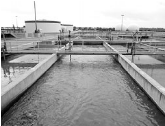
Estación depuradora de aguas residuales de Valladolid. / JESÚS LUQUE
