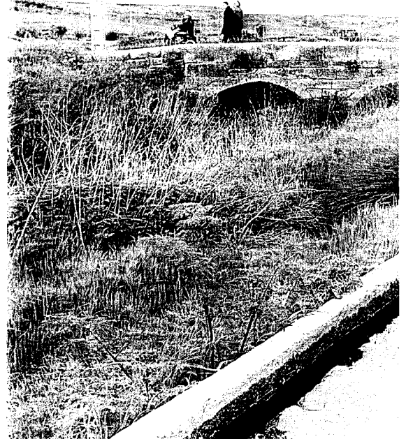
A la izquierda tramo del río en San Román de Hornija afectado por el
